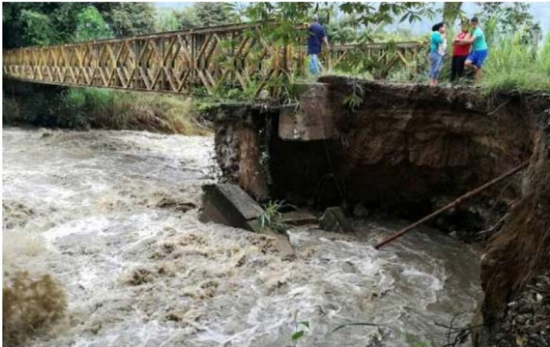
Deslizamientos por lluvias en Tolima y Antioquia, según el último reporte del Ideam, evidencian la vulnerabilidad de estas regiones, donde hay emergencias por las lluvias torrenciales. FOTO COLPRENSA
